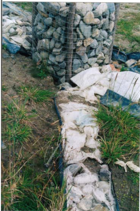
Fotografía 4: Ejemplo de canal de drenaje en un relleno sanitario
