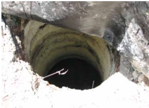
Figura 2. Pared del pozo de visita cubierta con azufre elemental.
