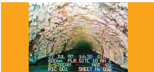
Figura 4. Apariencia de los tubos de concreto cuando son afectados por el biodeterioro.
