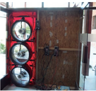
Figura 2.3: Equipo Model 3 Three Fan System Minneapolis instalado.
