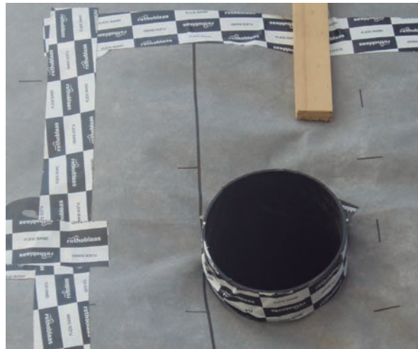
Figura 10.32: Sellos en las instalaciones
