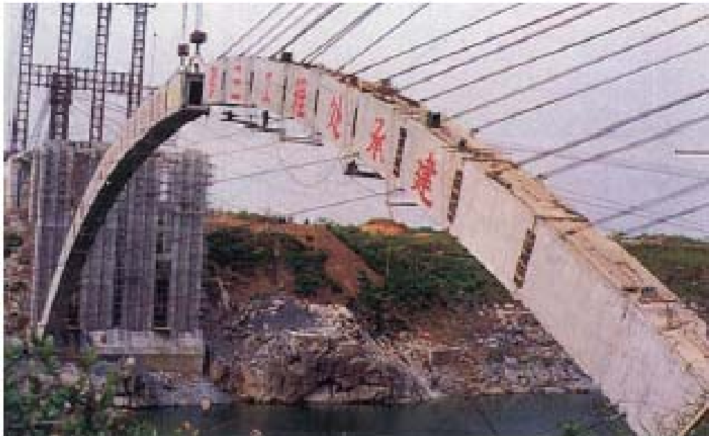
Construcción del arco. Obsérvese la sección de hormigón del arco en cajón
