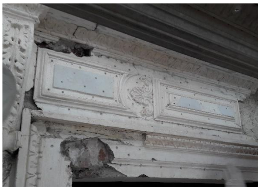
Imagen 47: Castro, F. 2017.Consolidación de tablero de ventana y ORE 12. Fotografías. Archivo personal.
