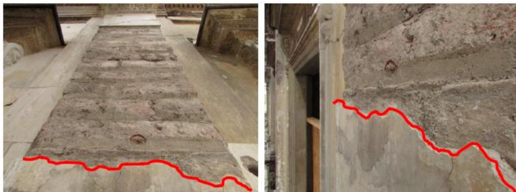
Imagen 7: Dirección de Arquitectura, MOP. 2014. Ejemplo de retiro de estuco, Fachada San Martín. Fotografía. Recuperado de: (Públicas, 2014, pág. 220)
