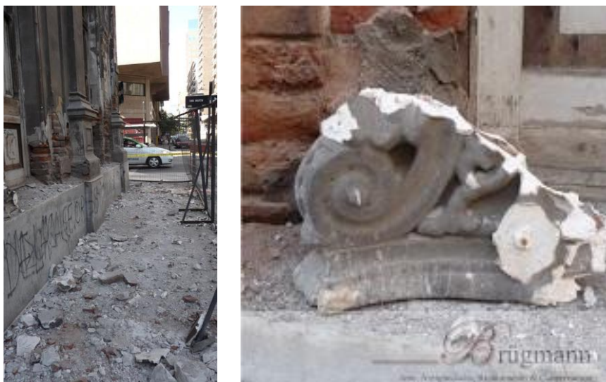
Imagen 32: BRÜGMANN. 2010. Daños provocados por el terremoto del 2010. Fotografía. Recuperado de: http://brugmannrestauradores.blogspot.cl/2011/09/palacio-pereira-la-ruina-mas-suntuosa.html .
