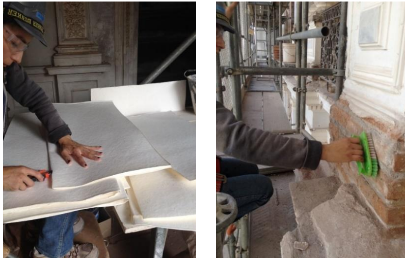
Imagen 14: Castro, F. 2017. Proceso de desalación, corte de celulosa y limpieza de muro. Fotografías. Archivo personal.
