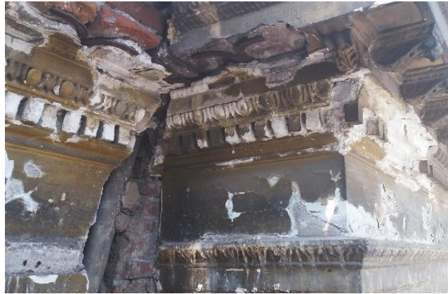
Imagen 33: Castro, F. 2017. Daños de humedad por escurrimiento de agua lluvia, fachada Huérfanos, etapa 2. Fotografía. Archivo personal.
