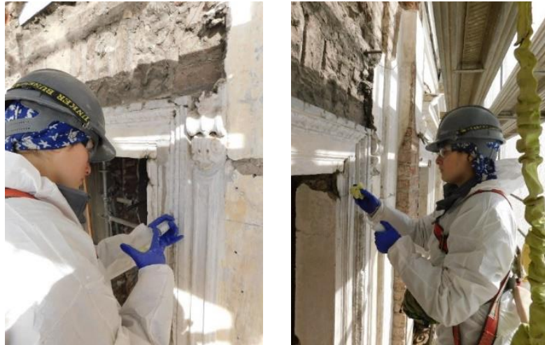
Imagen 18: KALAM. 2017. Proceso de consolidación, inyección de solución de Acril33 más agua destilada. Fotografía. Recuperado de: Restauración Palacio Pereira y reposición edificios CMN y DIBAM.
