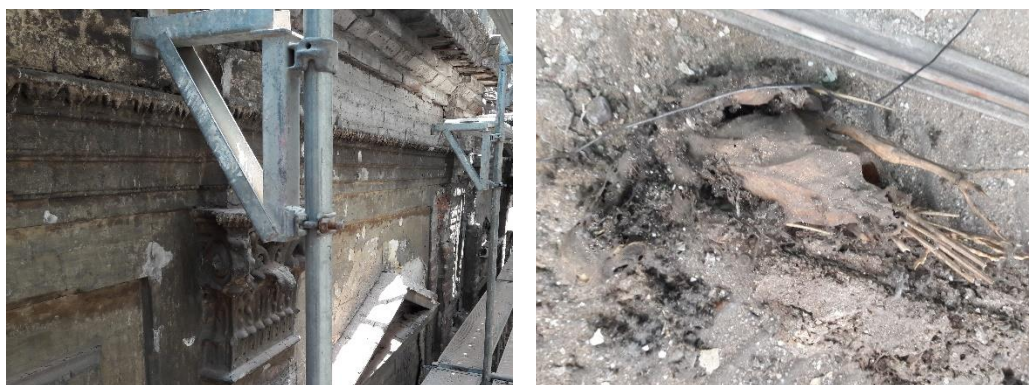
Imagen 35: Castro, F. 2017. Presencia de excremento y nidos de paloma en el arquivadros y coronación de pilastra del segundo nivel. Fachada San Martín, etapa 1. Fotografía. Archivo personal.
