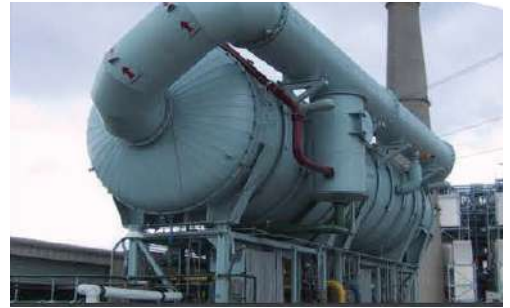
Planta de Compresión Mecánica de Vapor.
