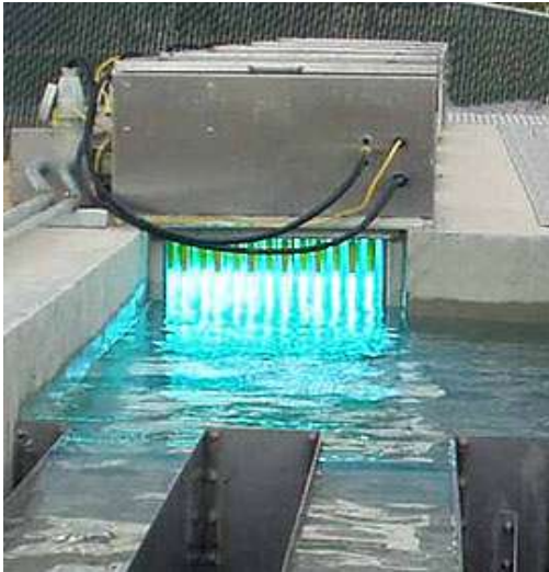
Tratamiento para bodegas con filtro UV Fuente: Aguasindustriales.es
