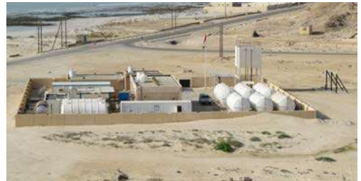
Planta de osmosis forzada en Al Khaluf, Omán.
