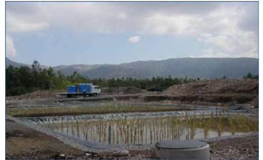
Sistema de tratamiento en humedal para tratamiento de efluentes mineros.
