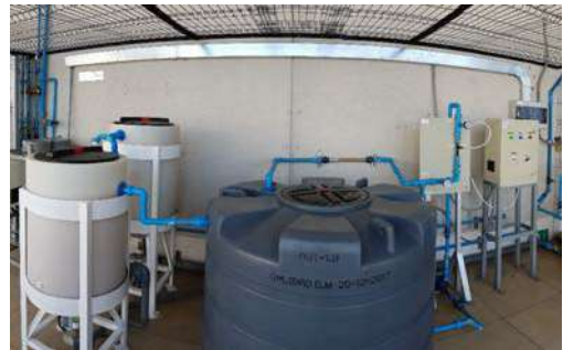
Sistema de tratamiento de aguas residencial. Fuente: EFIS Ltda. ( https://www.efislimitada.com/recicladoresdeaguasgrises )
