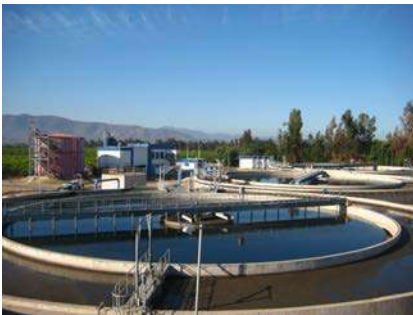
Tratamiento lodos activados. Fuente: Fundación Chile
