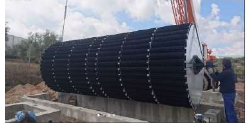
Instalación de biodiscos. Fuente: www.aguasresiduales.info/
