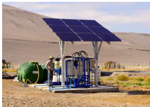
Planta desalinizadora con energía solar en región de Arica. Fuente: Fundación Chile, 2013
