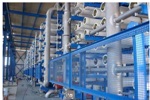
Bastidores de osmosis inversa de la desaladora de agua de mar Rambla Morales, en Almería, España.
