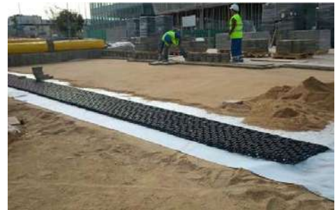
Celdas de polipropileno en sede del BBVA en Madrid. Fuente: ( http://drenajesostenible.com/productos-atlantis/ )
