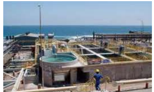
Planta de nanofiltración de Collahuasi. Fuente: Fundación Chile, 2010.
