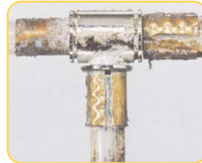
Uniones a presión de latón con tubería de plástico rotas después de un proceso de corrosión bajo tensiones (3)
