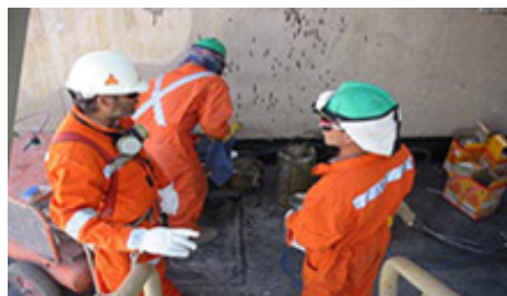
ESTANQUES PLANTA ÓXIDOS MINERA ESCONDIDA
