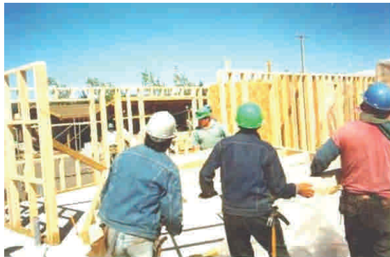
Figura 10 - 73b: Traslado manual del elemento prefabricado en obra, de dimensiones 3,20 m de ancho por 2,40 m de alto.
