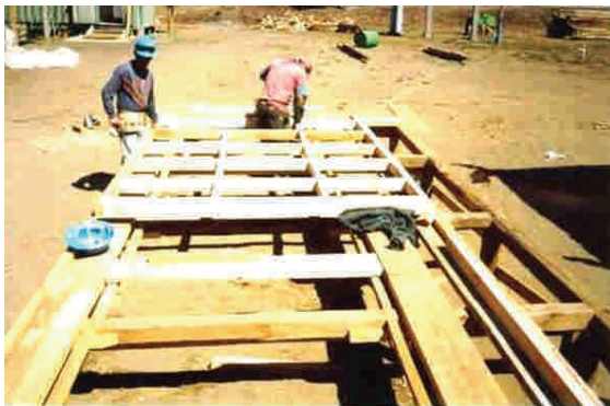
Figura 10 - 73a: Ejemplo de prefabricación de un tabique divisorio en mesa de armado en obra.
