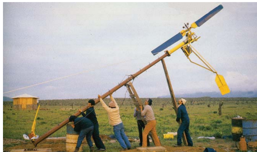
Figura IV.2.1: Aerogenerador de baja potencia (0,75kW) instalado en Comunidad Agrícola de Huentelauquén. Comuna de Canela. Región de Coquimbo. (Foto gentileza de ΤΕΚΗΝΕ)
