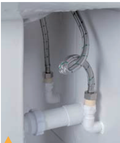
Estrangulamiento en flexible de agua.
